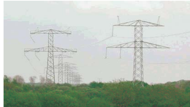
Donaumast - mastetype til 400 kV ledninger.
